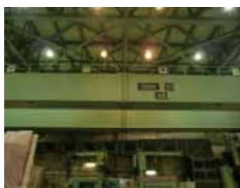
原子炉建屋クレーン
