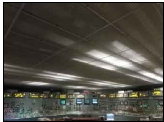
（直流非常灯点灯状態）
