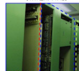
【制御盤間の分離】
