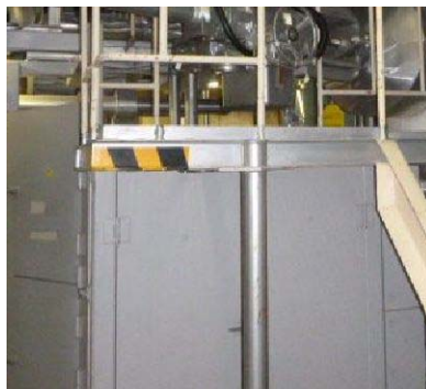
電動弁(遮蔽内に設置)
