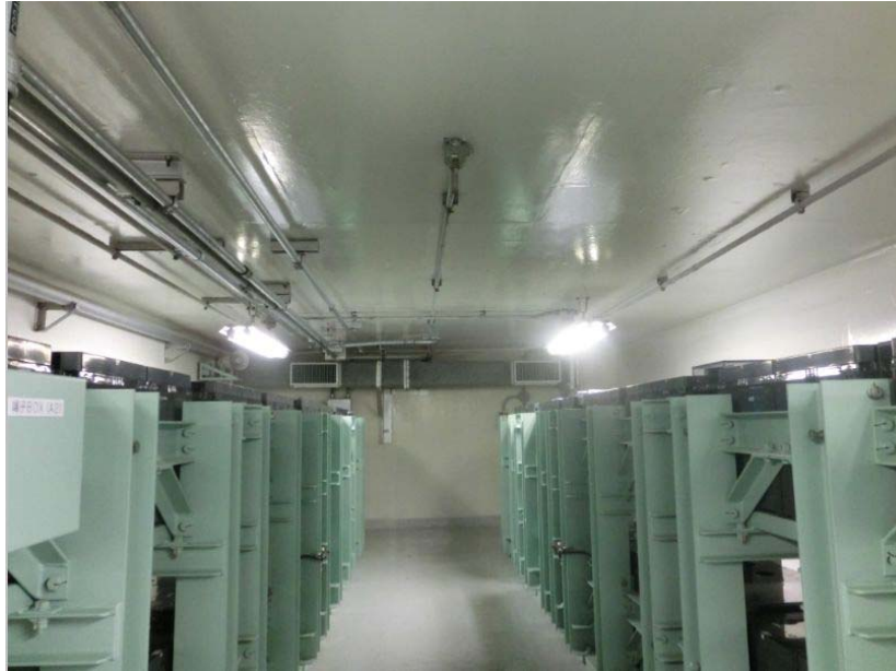
第 1-43 図 蓄電池の設置状況
