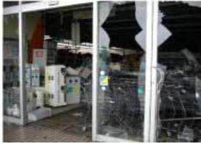
エントランスの窓ガラスの損壊
