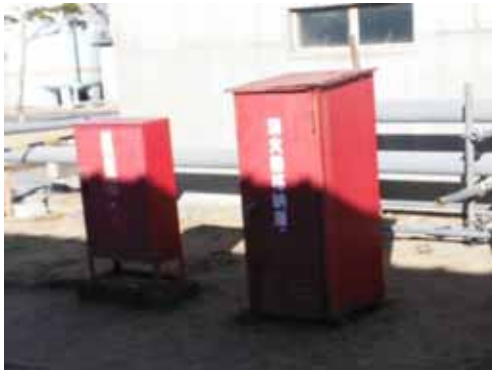
#152 消火設備格納箱
