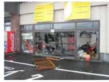
エントランスのガラス損壊
