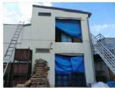
シャッターの外れ
