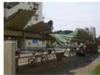
駐車場の折板屋根の著しい変形
