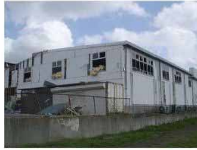
窓ガラスの損壊
