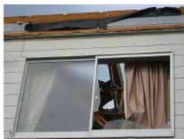
窓ガラスの損壊
