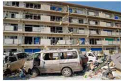
飛来物により被害を受けた住宅等
