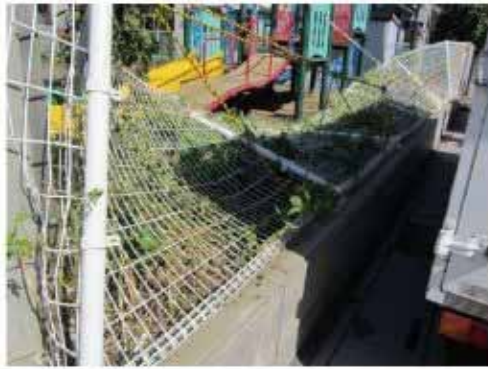
フェンスの変形
