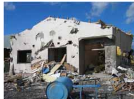
飛来物による被害を受けた建物
