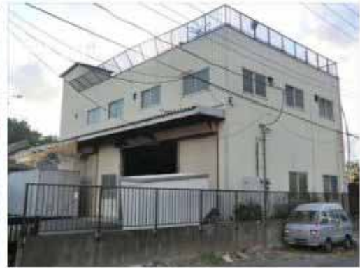
屋上フェンスの変形
