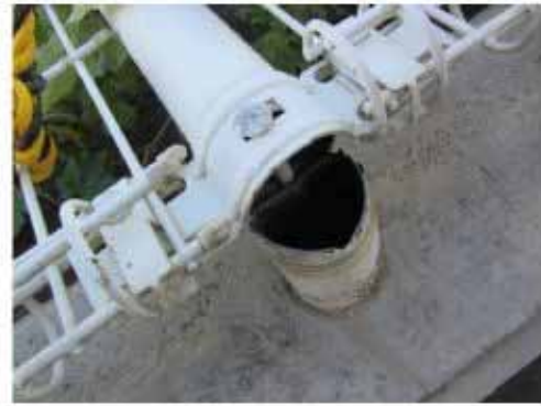
フェンス支柱部の破損
