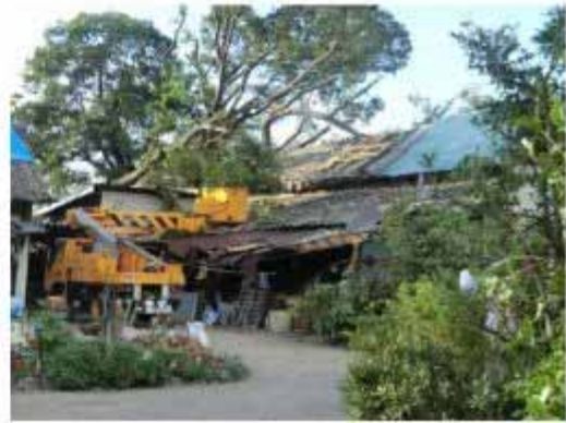
樹木の倒壊による小屋組の被害
