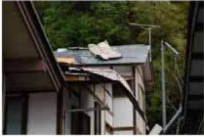
飛来物（鋼板製屋根材）の衝突
