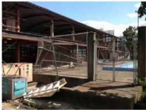
フェンスの変形（工事中の建築物）
