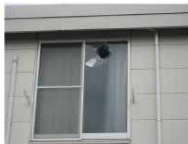
窓ガラスの飛来物衝突痕
