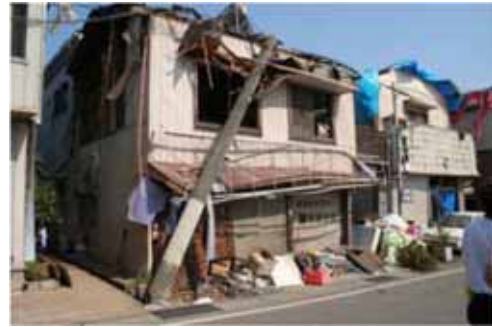
倒壊電柱に直撃された家屋
