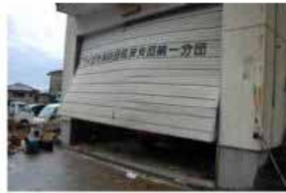
消防団施設のシャッターの変形
