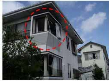
出窓部の窓ガラスの損壊
