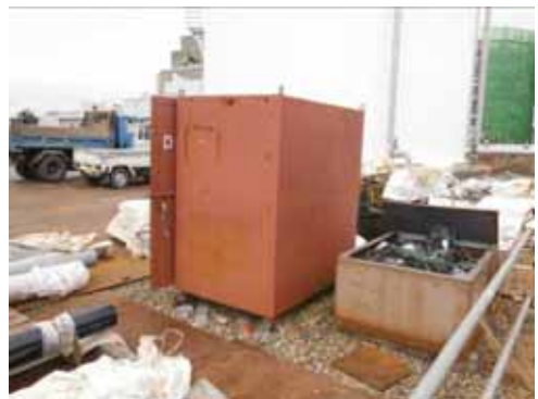
#62 鋼製ボックス
