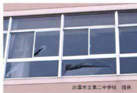
体育館窓ガラスの損壊
