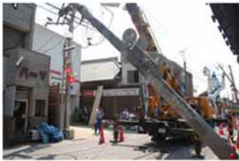
倒れた電柱(復旧作業時)
