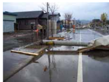
道路側へ倒壊した電柱
