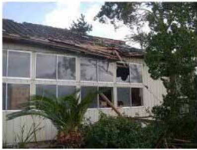
倉庫の窓ガラスと屋根の被害状況
