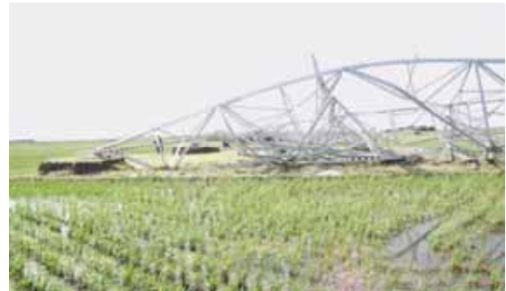
強風による送電鉄塔の倒壊事例 1
