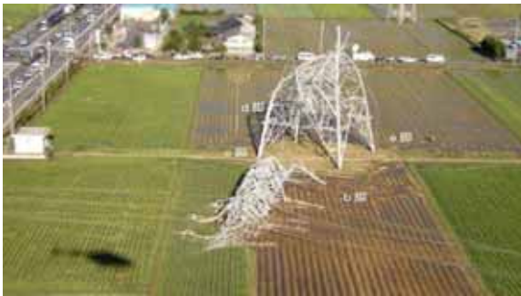
強風による送電鉄塔の倒壊事例 1
