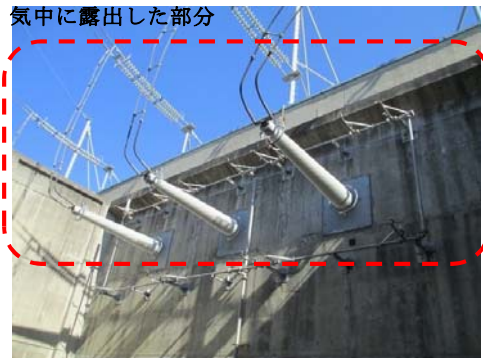
i) 275kV 送電線引込部
