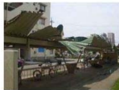
駐車場の折板屋根の著しい変形
