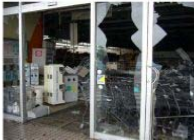
エントランスの窓ガラスの損壊
