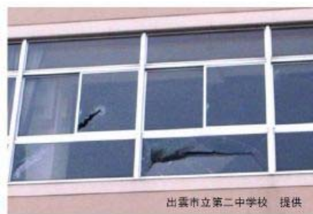
体育館窓ガラスの損壊
