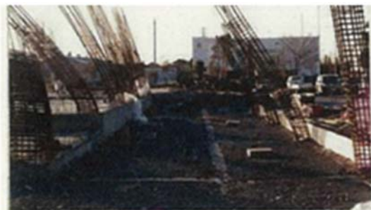
曲がった鉄筋（工事現場）
