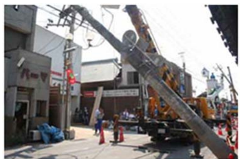
倒れた電柱(復旧作業時)
