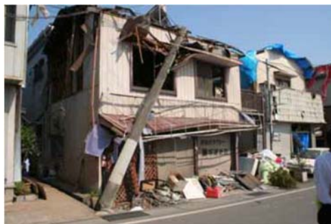
倒壊電柱に直撃された家屋
