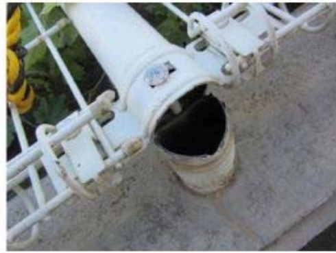
フェンス支柱部の破損
