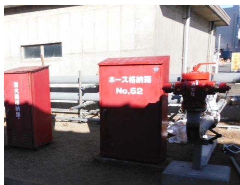
#153 消火設備格納箱
