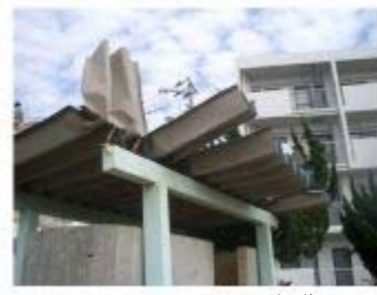
屋外トイレ屋根の損傷
