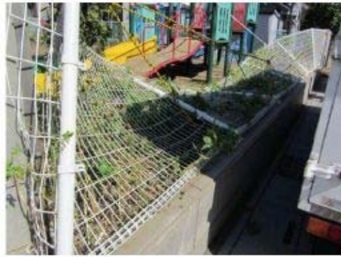
フェンスの変形
