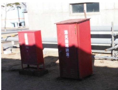
#152 消火設備格納箱
