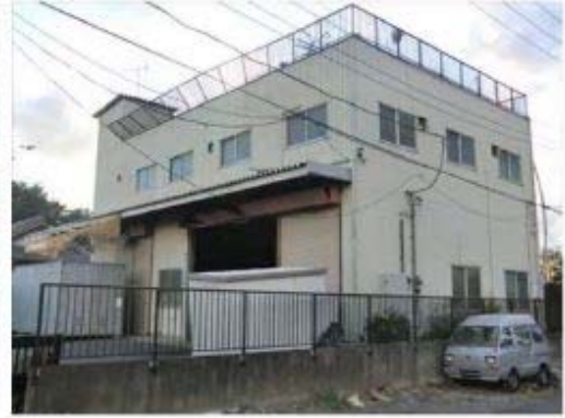
屋上フェンスの変形
