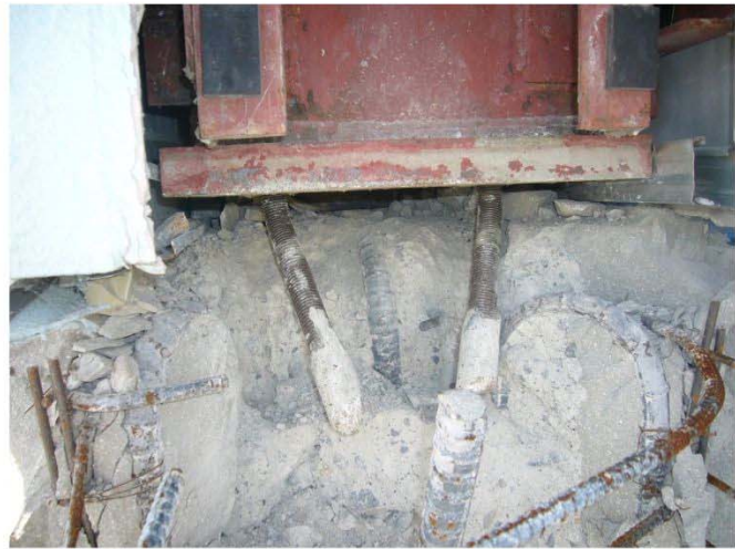
柱脚部コンクリート破壊
