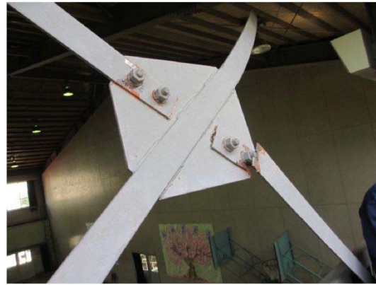
ブレース孔欠損部の破断
