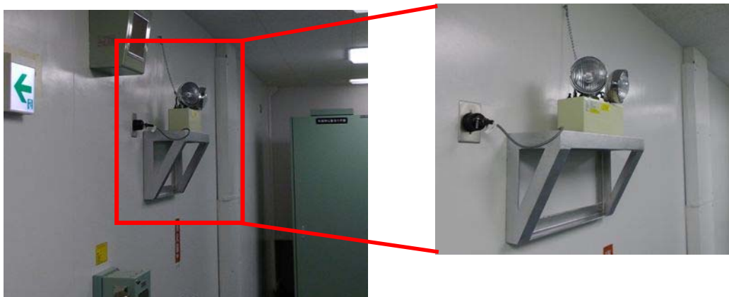
第2図 蓄電池内蔵型の照明
