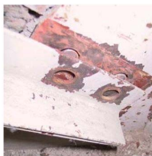
筋かい材ボルト破断
