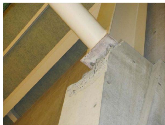
支承部コンクリート側方破壊
