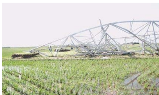
強風による鉄塔の倒壊事例②※ 1
