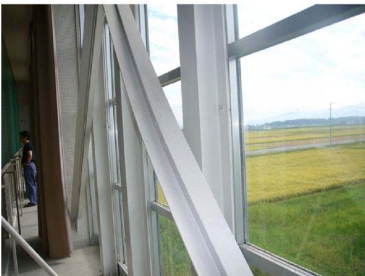
筋かい材の座屈（刈羽村）
