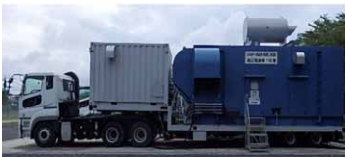
常設代替交流電源装置
