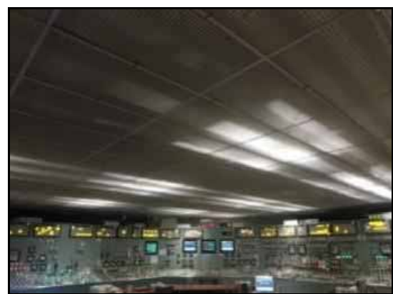
（直流非常灯点灯状態）
