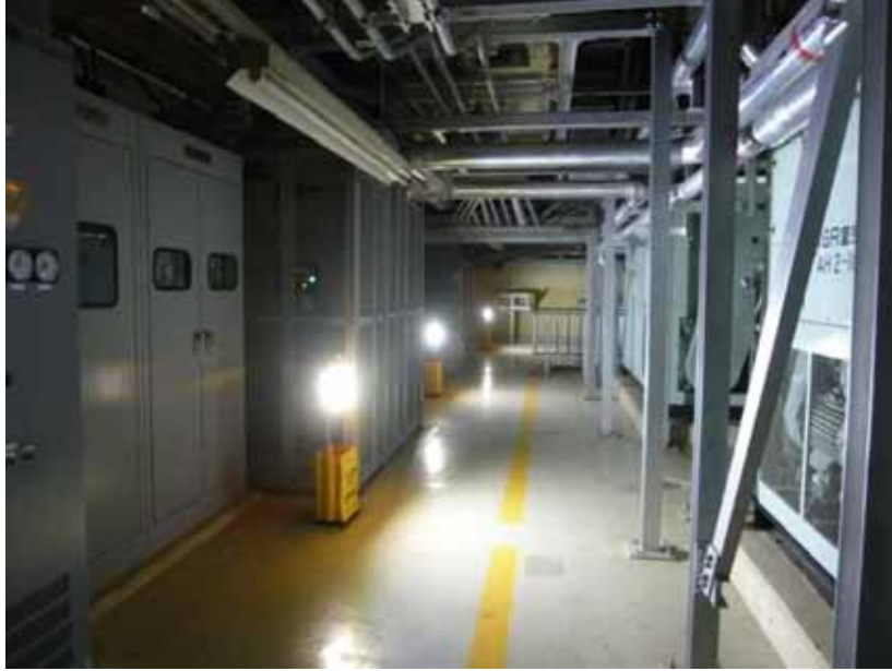
第 3.3-11 図 チェンジングエリア設置場所における 可搬型照明（S A）確認状況
