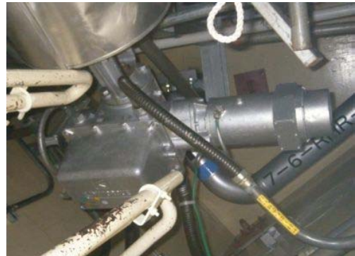
通路部上部の電動弁，電線管他
