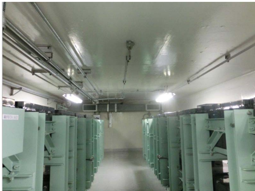
第 1-43 図 蓄電池の設置状況
