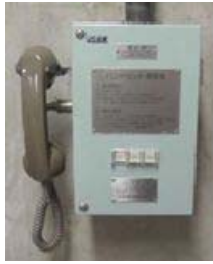
運転指令設備 (ページング)
