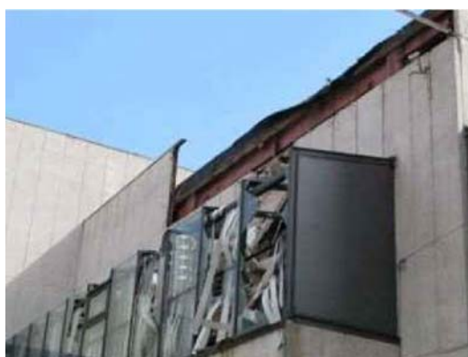
外装材の脱落，ガラス破損
