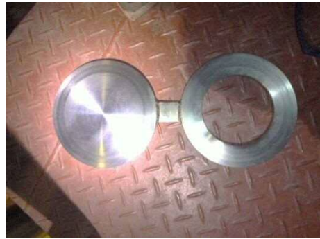
連絡配管閉止フランジ
