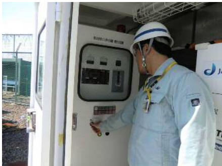
可搬型窒素供給装置 (小型) 起動
