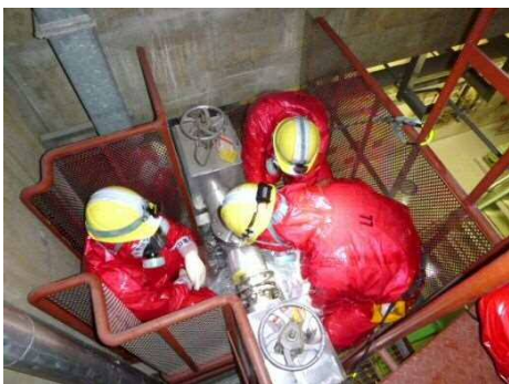
連絡配管閉止フランジ切替訓練
