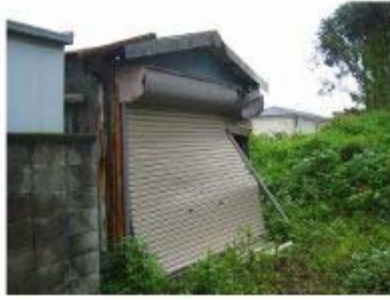
シャッターの外れ
