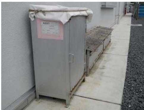
#287, #288 鋼製ボックス
