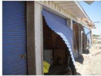
シャッターの外れ
