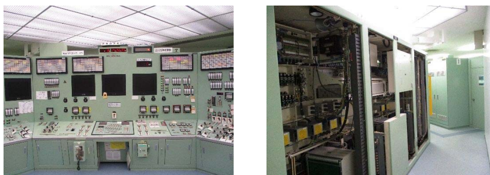
図3 原子炉制御盤（換気口無し）
