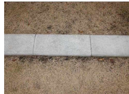
#81 コンクリート製蓋
