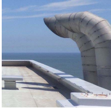
図5 ディーゼル発電機 排気管
