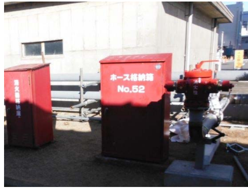
#153 消火設備格納箱
