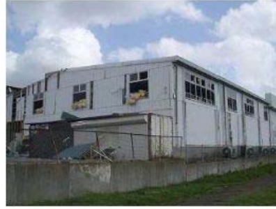
窓ガラスの損壊
