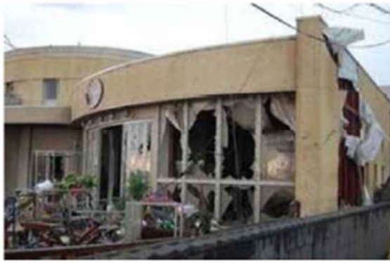
店舗の窓ガラスの被害状況
