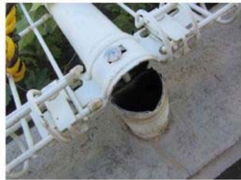
フェンス支柱部の破損
