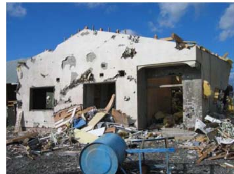
飛来物による被害を受けた建物
