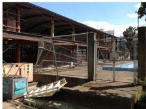
フェンスの変形（工事中の建築物）
