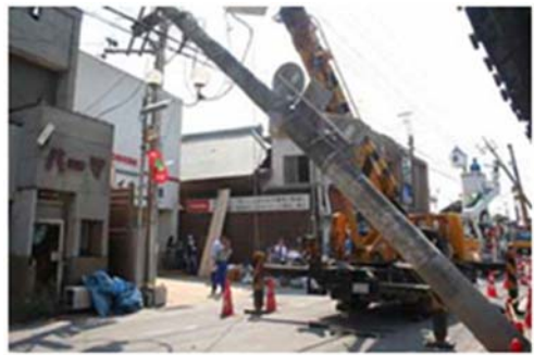
倒れた電柱(復旧作業時)
