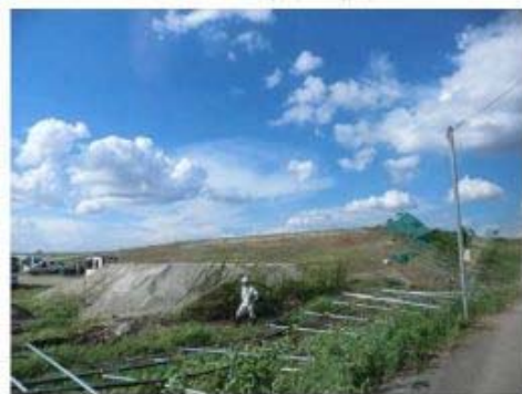
フェンスの倒壊
