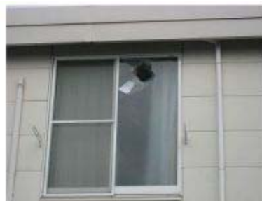
窓ガラスの飛来物衝突痕
