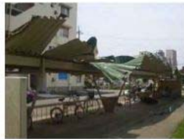
駐車場の折板屋根の著しい変形
