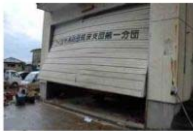
消防団施設のシャッターの変形
