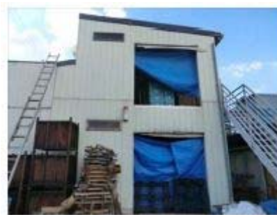
シャッターの外れ
