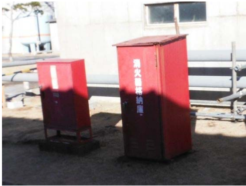
#152 消火設備格納箱
