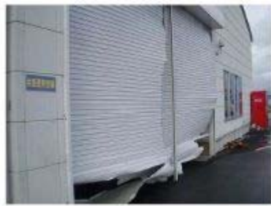
シャッターの変形
