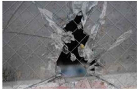
ガラスの被害状況（飛来物衝突痕）
