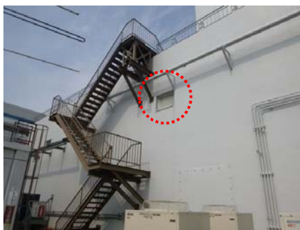
図2 外気取入口（中央制御室換気空調系）
