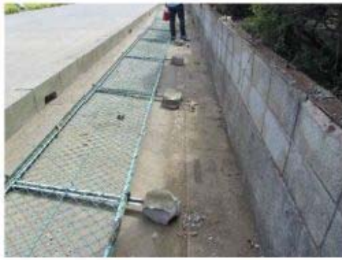
フェンスの倒壊
