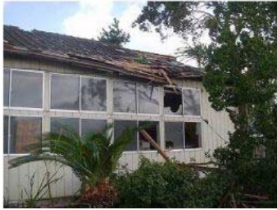
倉庫の窓ガラスと屋根の被害状況
