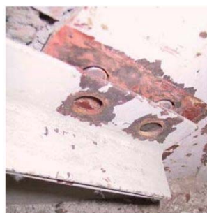
筋かい材ボルト破断
