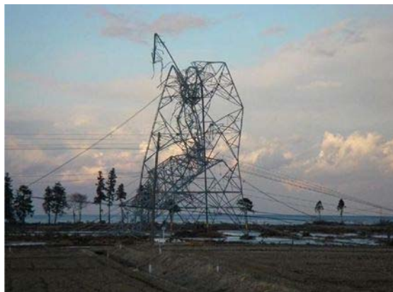
津波による隣接鉄塔の倒壊に伴う鉄塔の倒壊事例※2
