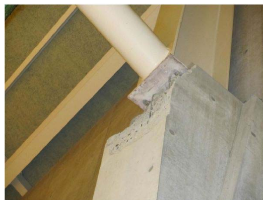
支承部コンクリート側方破壊
