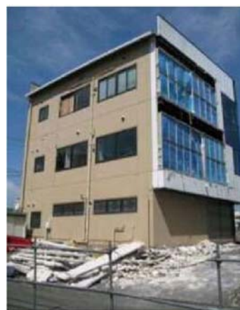
ALC パネルの脱落
