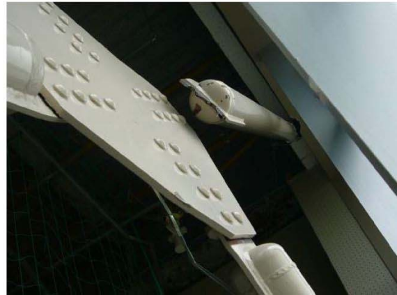
筋かい材プレート破断
