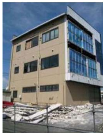
ALC パネルの脱落
