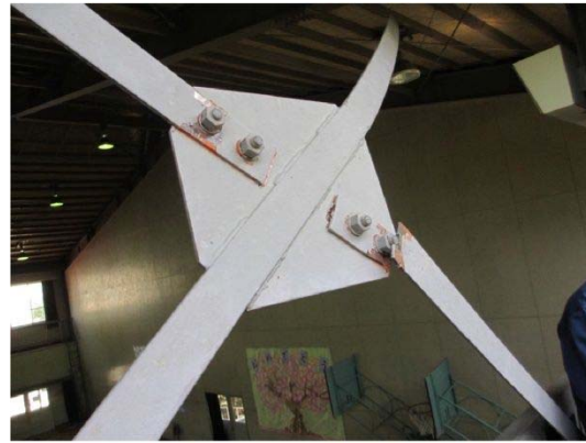
ブレース孔欠損部の破断
