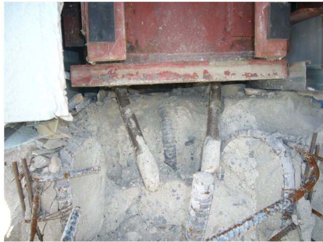
柱脚部コンクリート破壊
