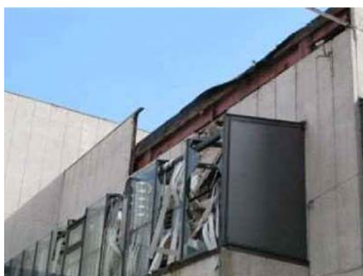
外装材の脱落，ガラス破損
