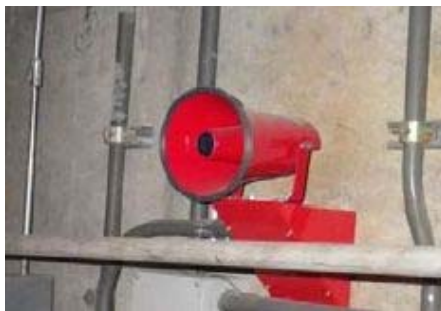
退避サイレン用音響装置
