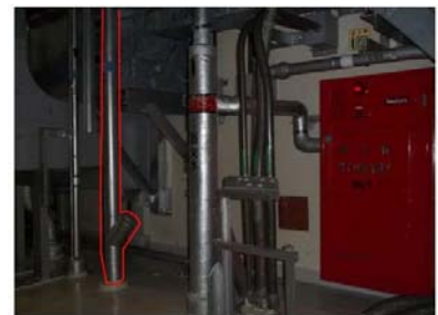
配管の設置例
