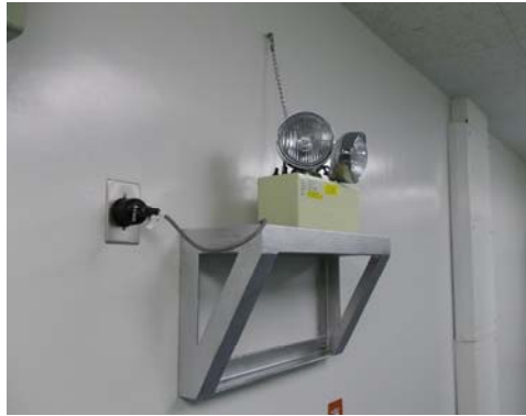
第 1.0.13-6 図 蓄電池内蔵型照明の例
