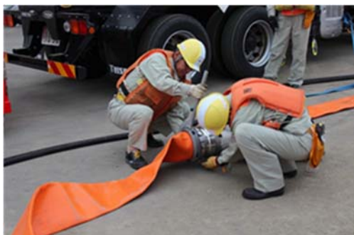
可搬型代替注水大型ポンプの訓練の状況 （写真はホースを接続するクランプ部の接続作業）
