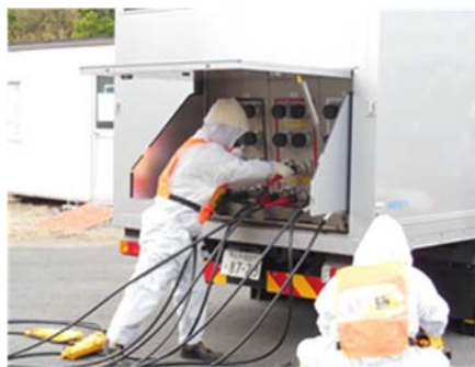
移動式高圧電源車の訓練の状況 （写真は過酷環境を想定した服装による，電源ケーブルを接続作業）
