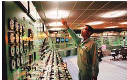
シミュレータを用いた運転操作訓練の状況 （写真は社外施設での実施状況，電源喪失時を想定）
