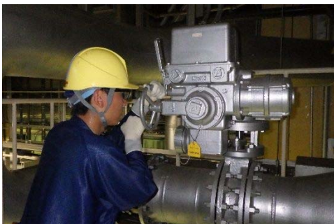
耐圧強化ベント現場操作
