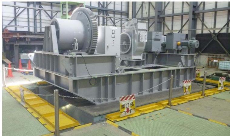
第8図 開閉装置の試験装置（全景）
