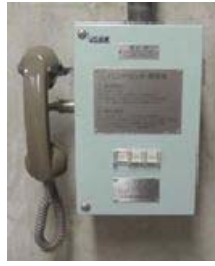
運転指令設備 (ページング)
