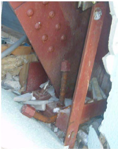
アンカーボルト引き抜け
