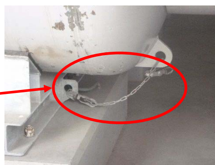
プロパンボンベ庫 プロパンボンベの固縛状況
