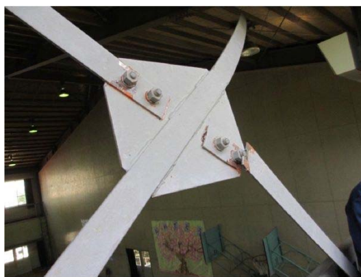
ブレース孔欠損部の破断
