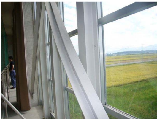
筋かい材の座屈（刈羽村）
