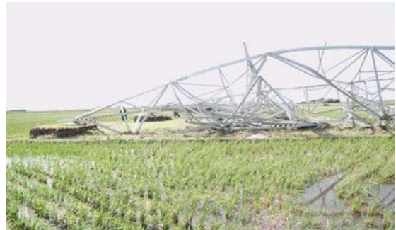
強風による鉄塔の倒壊事例②※ 1
