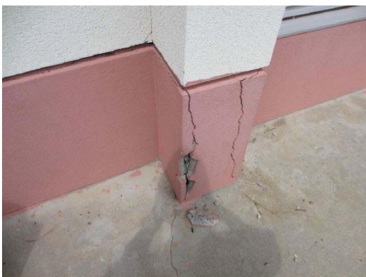
柱脚部コンクリートのひび割れ
