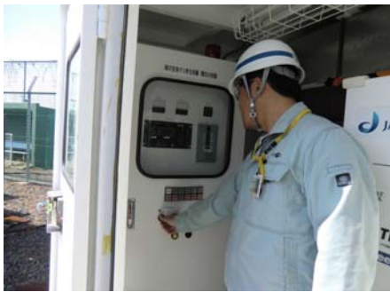
可搬型窒素供給装置（小型）起動
