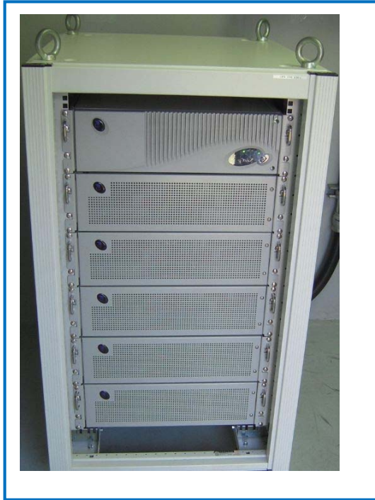
無停電電源装置
