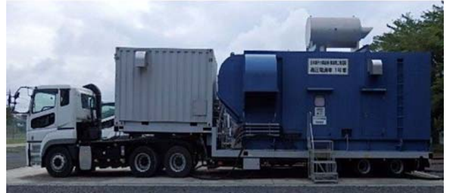
常設代替交流電源装置
