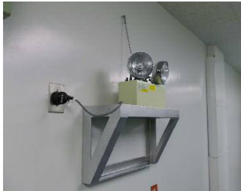
第 1.0.13-7 図 蓄電池内蔵型照明の例
