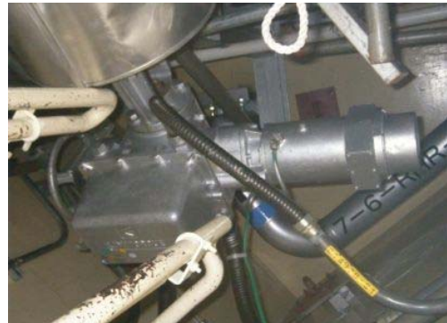
通路部上部の電動弁，電線管他
