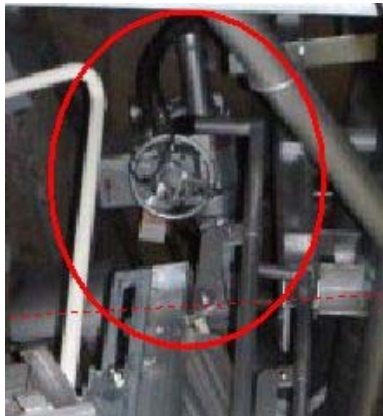
通路上部の電動弁，電線管他
