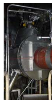
通路上部の電動弁
