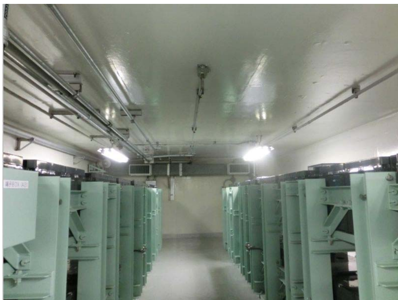
第1-43図 蓄電池の設置状況
