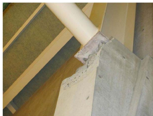
支承部コンクリート側方破壊
