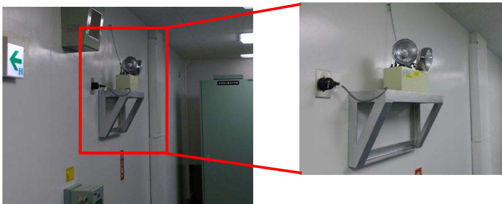
第2図 蓄電池内蔵型の照明
