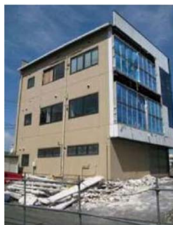
ALC パネルの脱落
