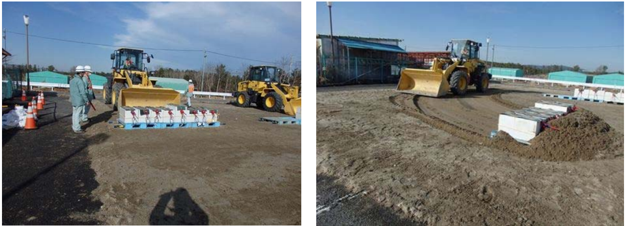
第6図 がれき撤去検証の写真
