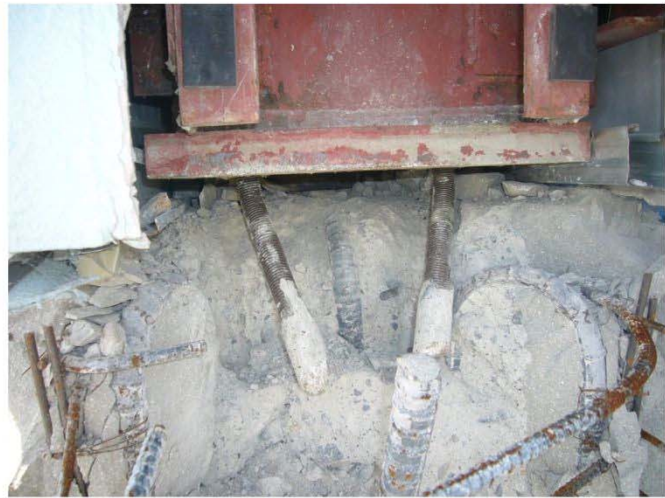
柱脚部コンクリート破壊
