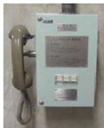
運転指令設備 (ページング)
