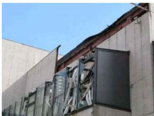
外装材の脱落，ガラス破損
