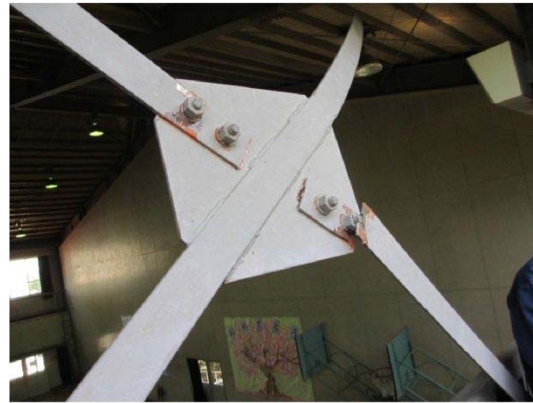
ブレース孔欠損部の破断
