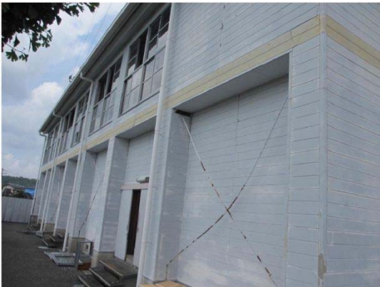
筋かい材の変形
