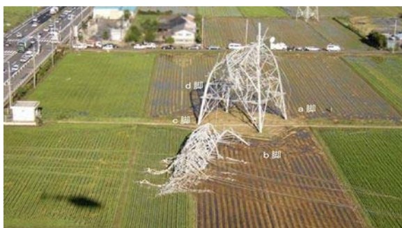
強風による鉄塔の倒壊事例①※ 1
