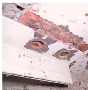
筋かい材ボルト破断
