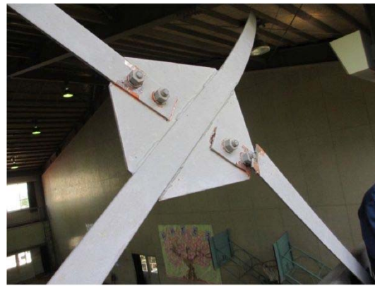
ブレース孔欠損部の破断
