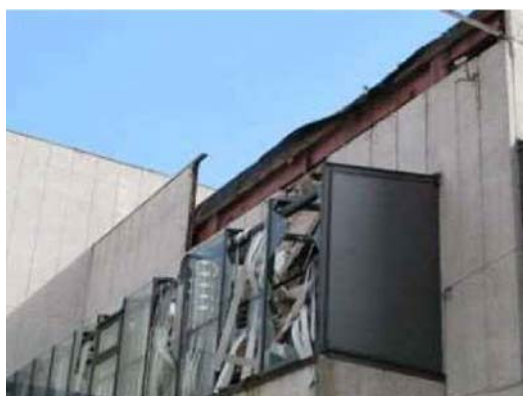
外装材の脱落，ガラス破損
