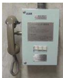
運転指令設備 (ページング)
