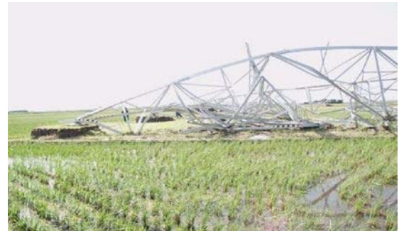
強風による鉄塔の倒壊事例②※ 1
