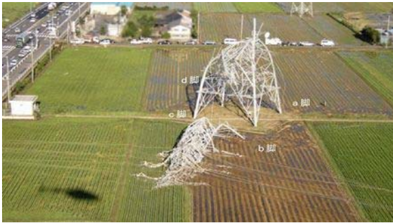
強風による鉄塔の倒壊事例①※ 1
