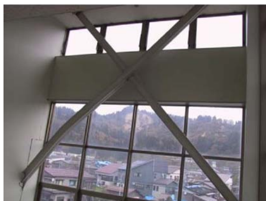
ブレース材の座屈
