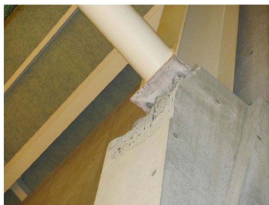
支承部コンクリート側方破壊
