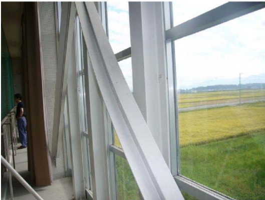
筋かい材の座屈（刈羽村）
