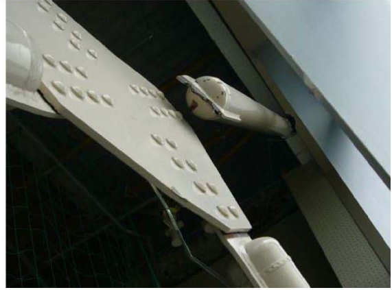
筋かい材プレート破断
