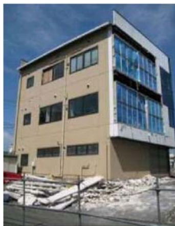
ALC パネルの脱落
