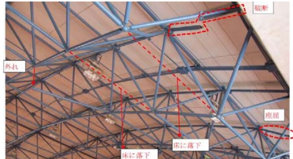
筋かい材の座屈・落下
