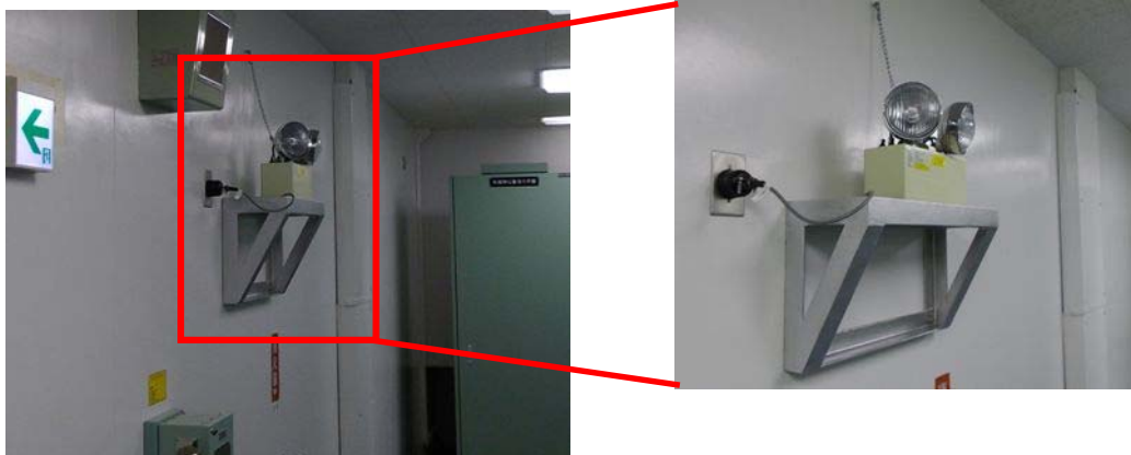
第2図 蓄電池内蔵型の照明
