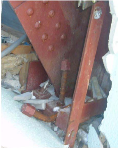
アンカーボルト引き抜け
