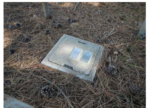
#418 コンクリート製蓋
