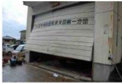
消防団施設のシャッターの変形
