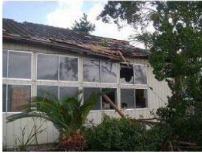
倉庫の窓ガラスと屋根の被害状況
