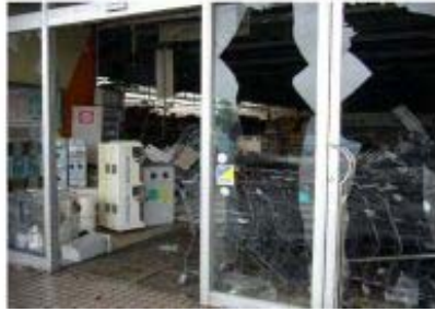
エントランスの窓ガラスの損壊
