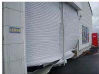
シャッターの変形
