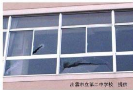
体育館窓ガラスの損壊
