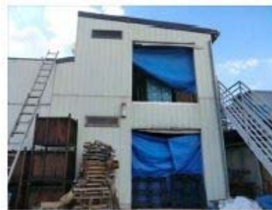
シャッターの外れ
