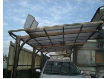
カーポート屋根の損傷
