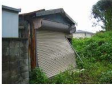
シャッターの外れ
