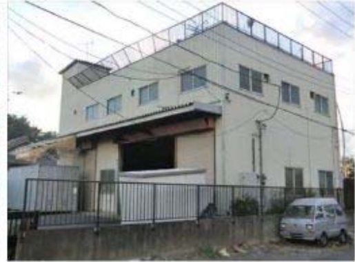
屋上フェンスの変形
