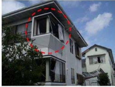
出窓部の窓ガラスの損壊
