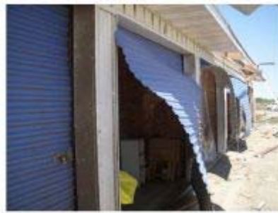
シャッターの外れ
