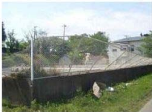
フェンスの変形
