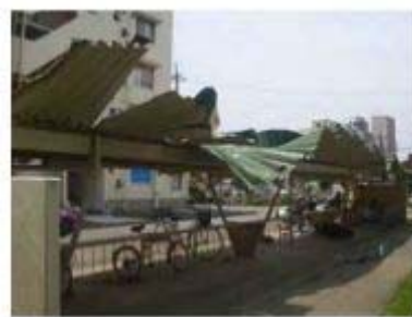
駐車場の折板屋根の著しい変形
