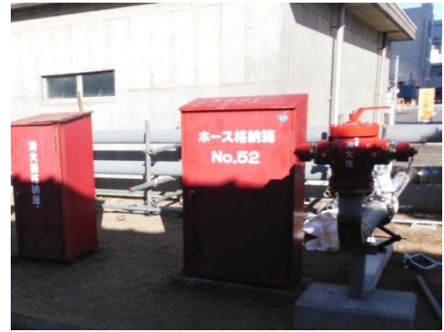
#153 消火設備格納箱
