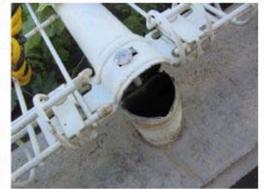
フェンス支柱部の破損
