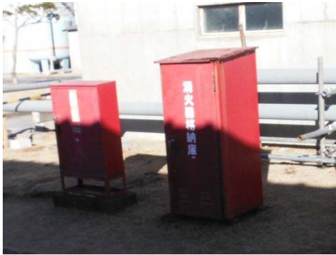
#152 消火設備格納箱
