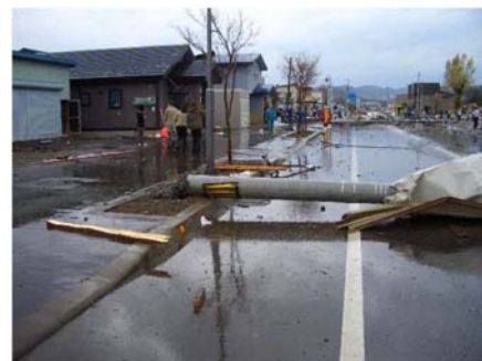
道路側へ倒壊した電柱
