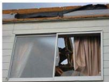
窓ガラスの損壊
