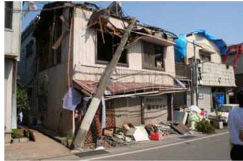
倒壊電柱に直撃された家屋
