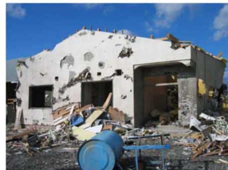
飛来物による被害を受けた建物
