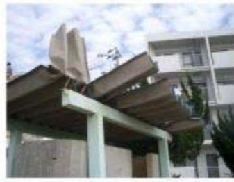
屋外トイレ屋根の損傷
