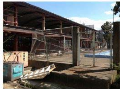
フェンスの変形（工事中の建築物）
