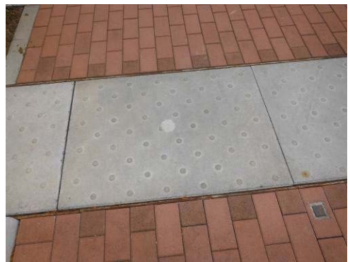
#54 コンクリート製蓋
