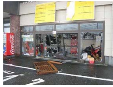
エントランスのガラス損壊
