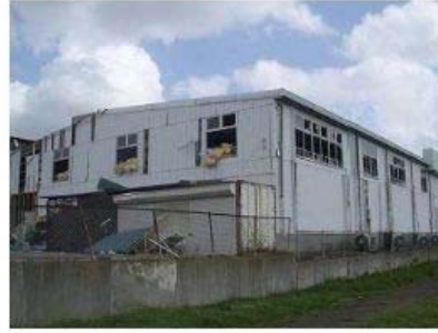
窓ガラスの損壊
