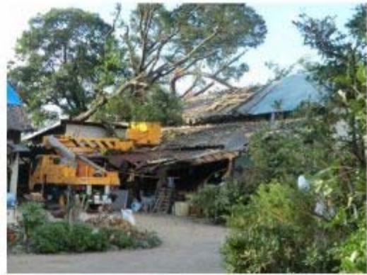
樹木の倒壊による小屋組の被害
