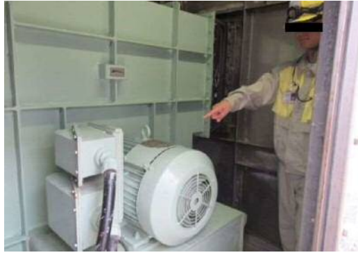
空調機運転状態確認
