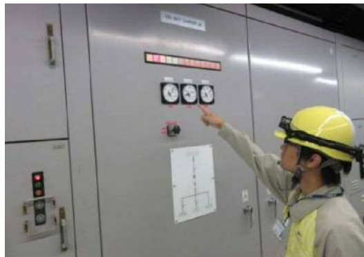
充電器運転状態確認
