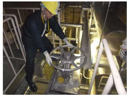
原子炉冷却材浄化系 再生熱交換器バイパス運転操作 (⑳原子炉冷却材浄化系 再生熱交換器バイパス弁)
