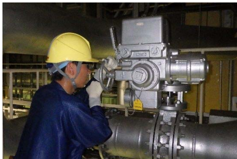
耐圧強化ベント現場操作
