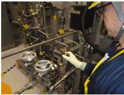
ポンプメカシールパージ流量調整操作 (⑭, ⑱原子炉冷却材浄化系ポンプ メカシールパージ水ライン調整弁)
