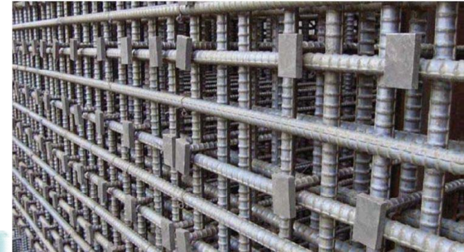
壁部材への適用状況
