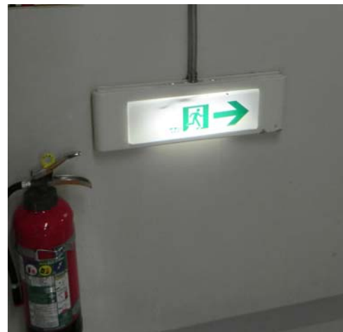
通路誘導灯（廊下・通路）
