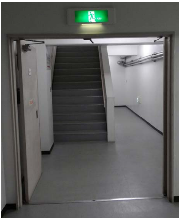
避難口誘導灯
