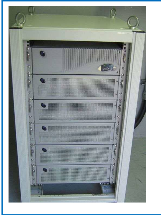
無停電電源装置
