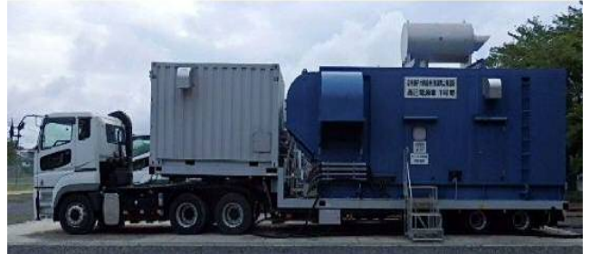
常設代替交流電源装置
