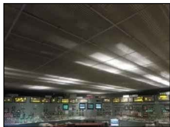
（直流非常灯点灯状態）
