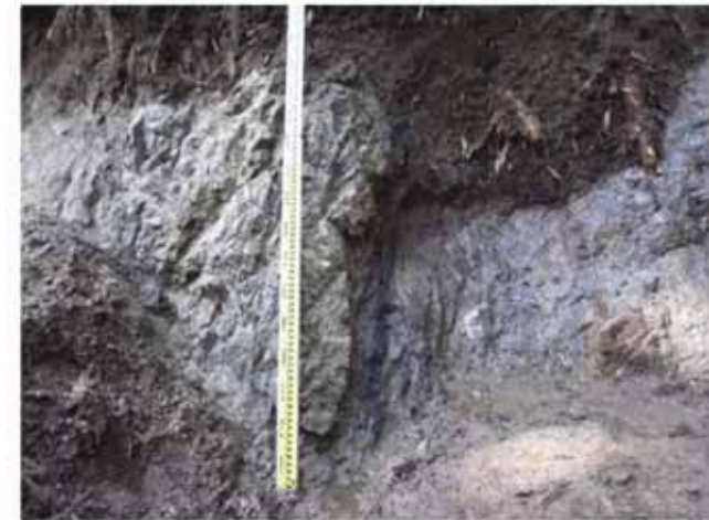
写真 断層部の全景
