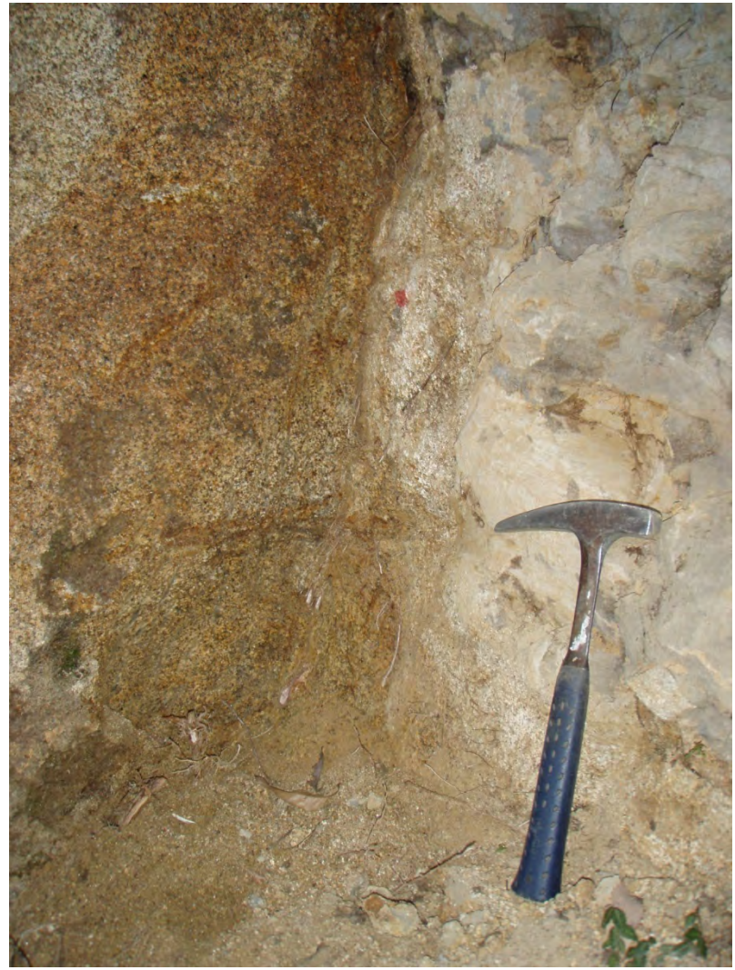
写真4 断層面の癒着した断層 (拡大)
