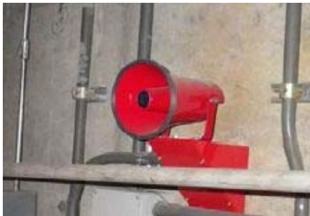
退避サイレン用音響装置
