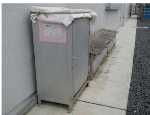
#287, #288 鋼製ボックス
