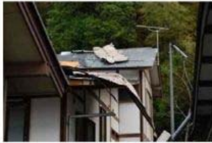
飛来物（鋼板製屋根材）の衝突
