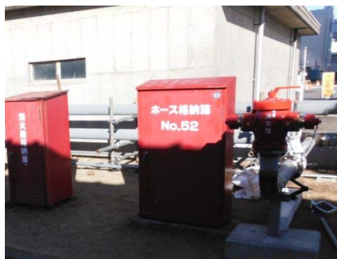
#153 消火設備格納箱
