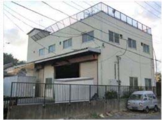
屋上フェンスの変形
