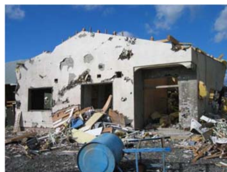
飛来物による被害を受けた建物
