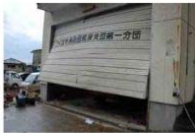
消防団施設のシャッターの変形
