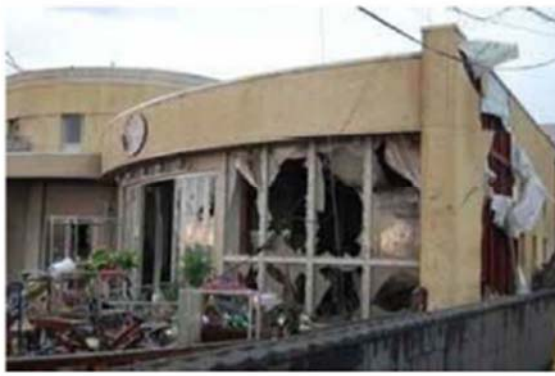
店舗の窓ガラスの被害状況
