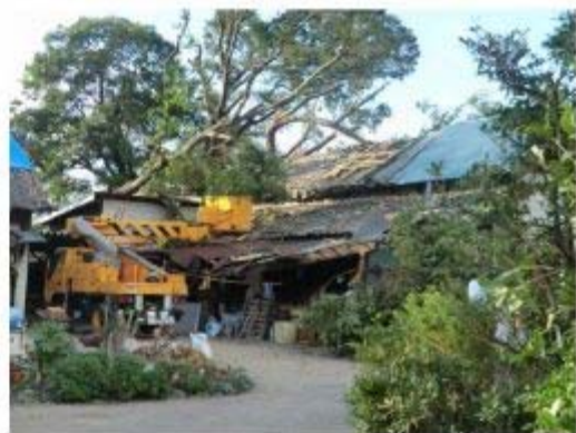
樹木の倒壊による小屋組の被害
