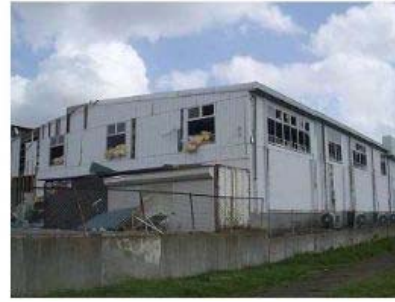
窓ガラスの損壊
