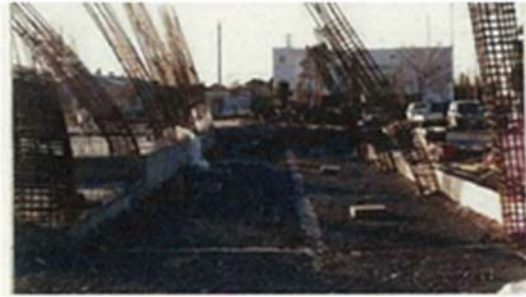
曲がった鉄筋（工事現場）
