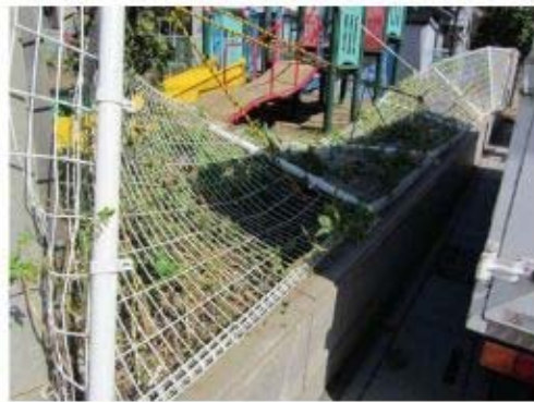
フェンスの変形
