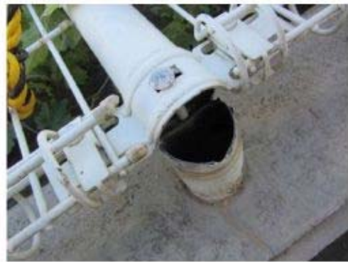
フェンス支柱部の破損
