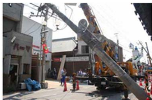
倒れた電柱(復旧作業時)
