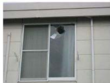
窓ガラスの飛来物衝突痕
