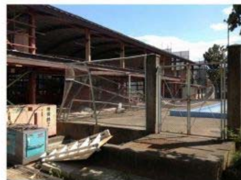
フェンスの変形（工事中の建築物）
