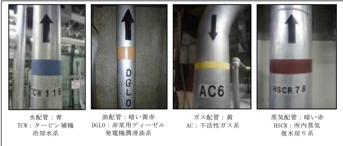
第 2.4.2-2 図 配管の識別管理（例）
