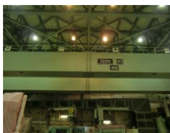
原子炉建屋クレーン
