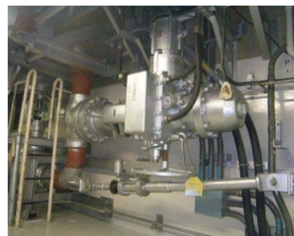
電動弁及び電線管他
