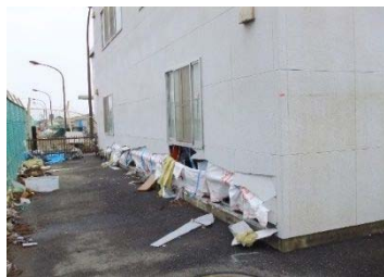
① 輸送本部建屋（S造） 津波による外装材破損
