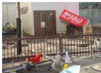
③ メンテナンスセンター（S造） 自動販売機転倒
