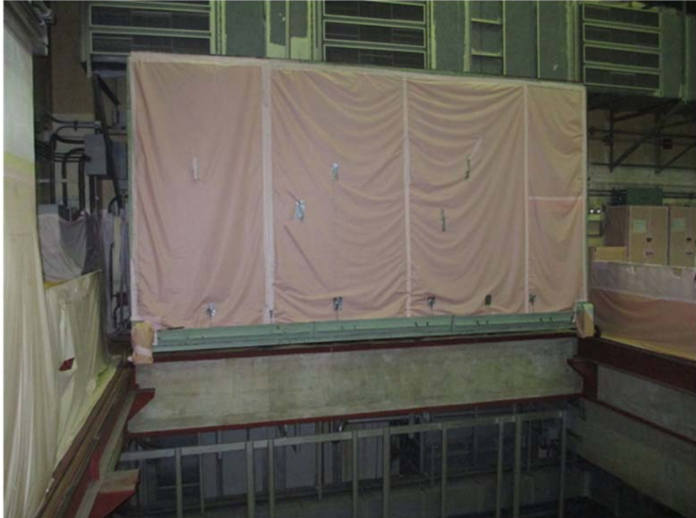
第2図 大物搬入口ハッチの開状態
