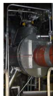
通路上部の電動弁
