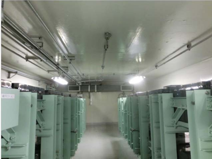
第41-1-41図 蓄電池の設置状況
