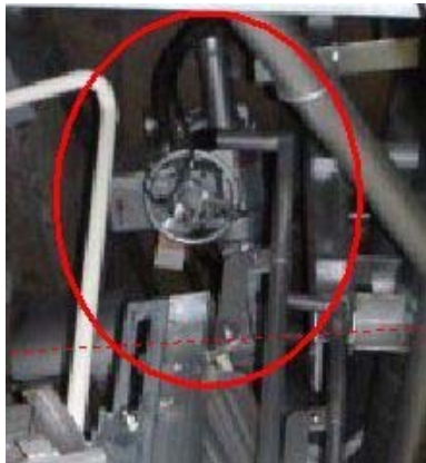
通路上部の電動弁，電線管他
