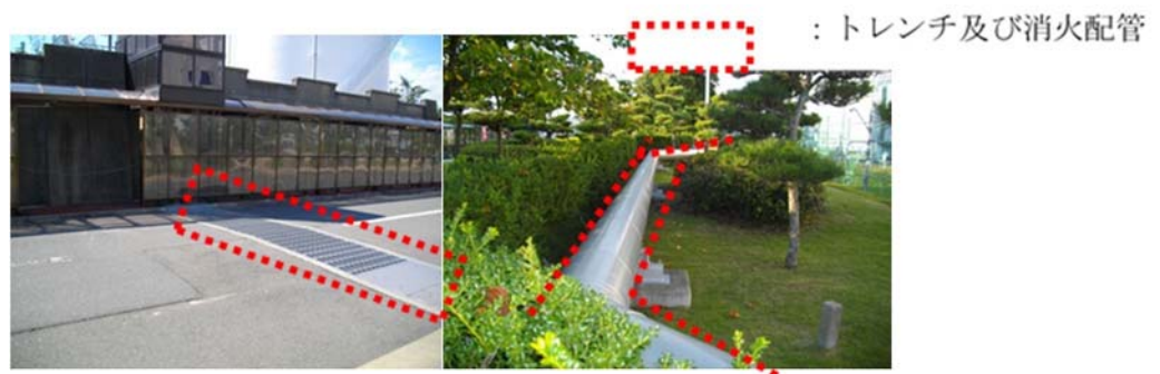
第41-1-39図 消火配管地下トレンチ, 地上化状況
