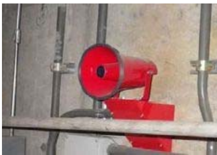
退避サイレン用音響装置
