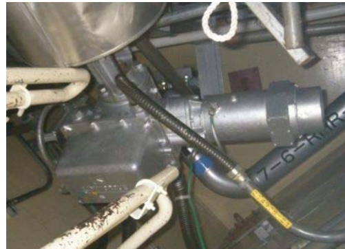
通路部上部の電動弁，電線管他
