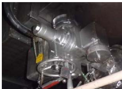
通路上部の電動弁
