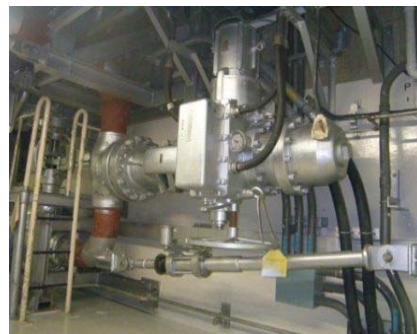
電動弁及び電線管他
