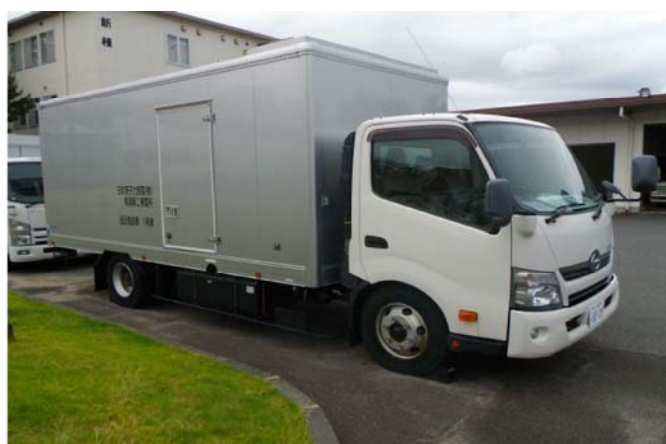
可搬型代替交流電源設備
