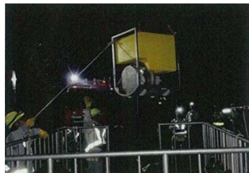
夜間での送水訓練 (ポンプ設置)
