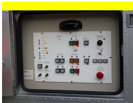
低圧ケーブル接続箇所（可搬型代替低圧電源車）
