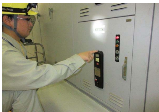
不要負荷切離し（遮断器）
