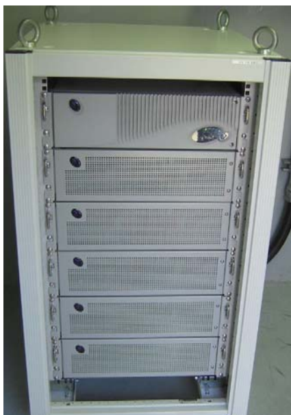
無停電電源装置
