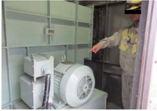
空調機運転状態確認
