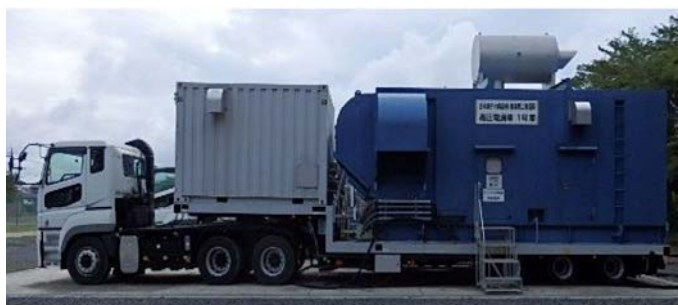
常設代替交流電源設備
