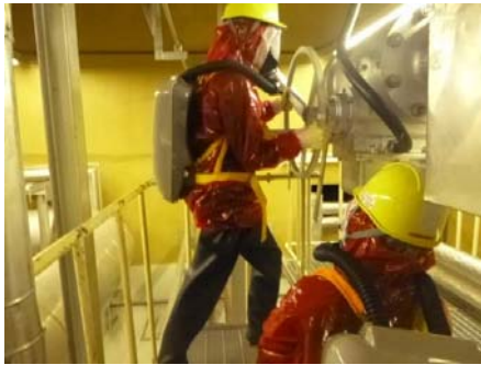
現場手動隔離操作 (放射線防護具着用)
