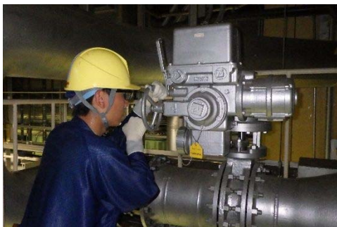
耐圧強化ベント現場操作
