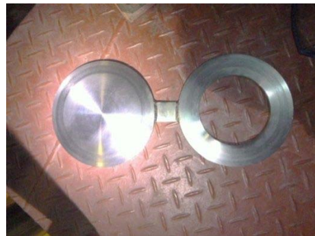
連絡配管閉止フランジ
