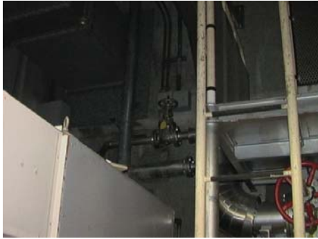
系統構成 (⑬補助ボイラ冷却水元弁)
