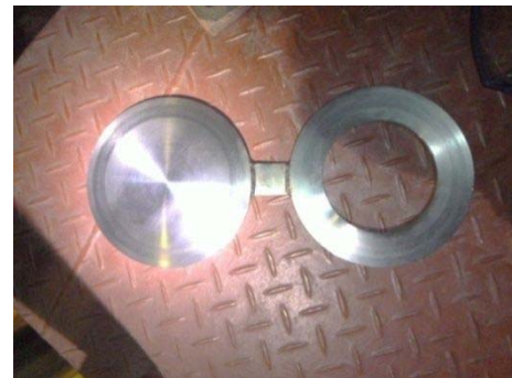
連絡配管閉止フランジ
