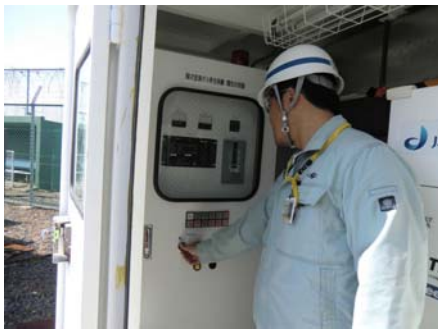
可搬型窒素供給装置（小型）起動
