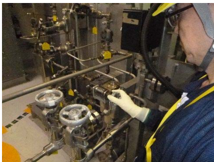
ポンプメカシールパージ流量調整操作 （⑭，⑯原子炉冷却材浄化系ポンプ メカシールパージ水ライン調整弁）
