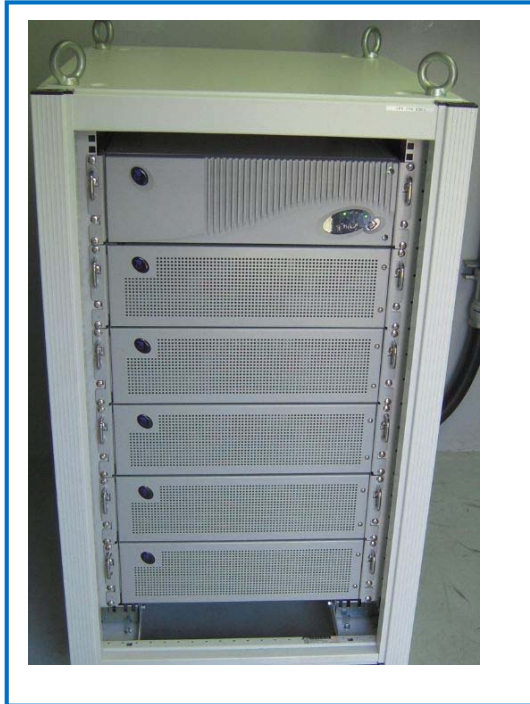
無停電電源装置
