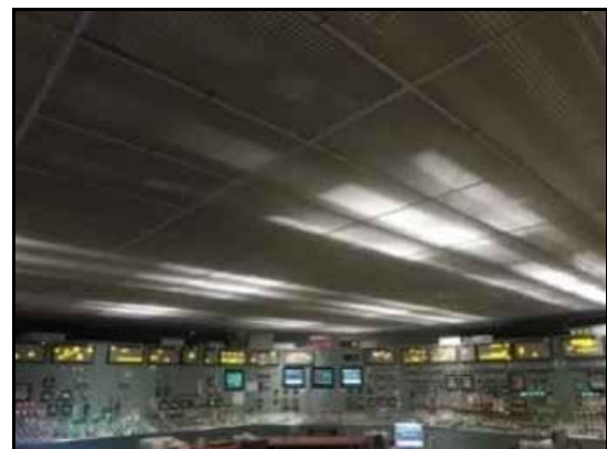
（直流非常灯点灯状態）
