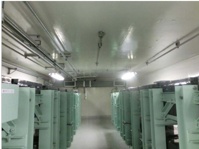
第 1-43 図 蓄電池の設置状況
