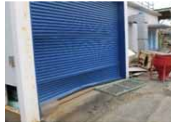
メンテナンスセンター（Ｓ造） シャッター変形
