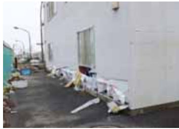
輸送本部建屋（Ｓ造） 津波による外装材破損
