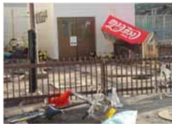
メンテナンスセンター（Ｓ造） 自動販売機転倒
