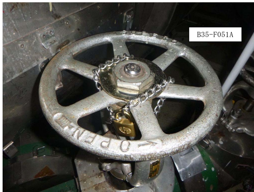
第 2-2 図 原子炉再循環ポンプ（A）系C UW入口ドレン弁 施錠状態
